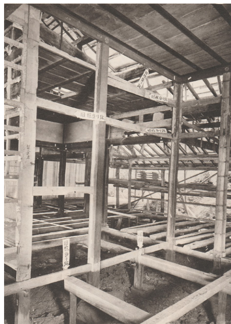
【奥書院修理工事報告書】第46図 旧上段の間（現在春の間）残存資料
